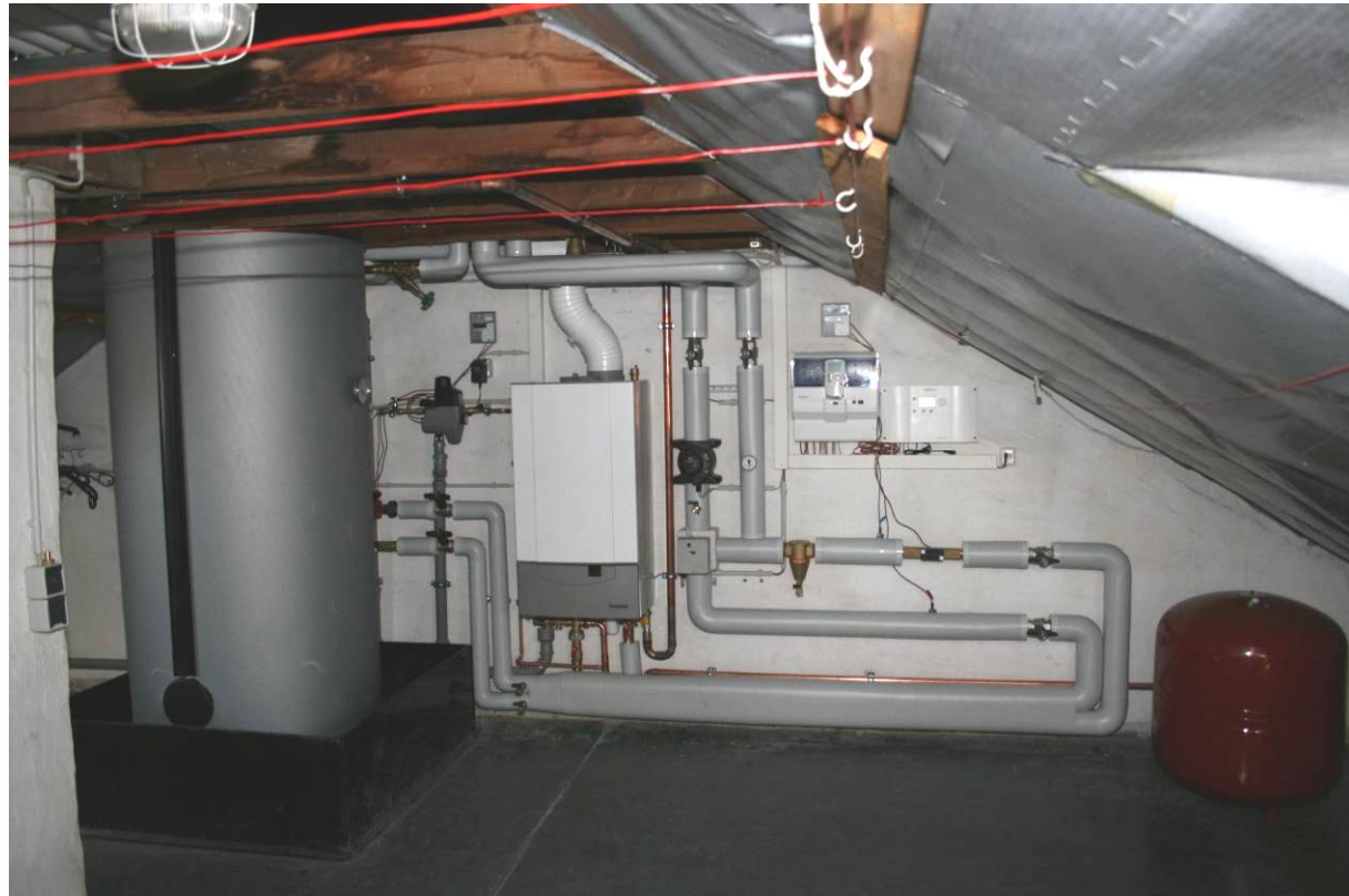
Heizzentrale mit Warmwasserspeicher
