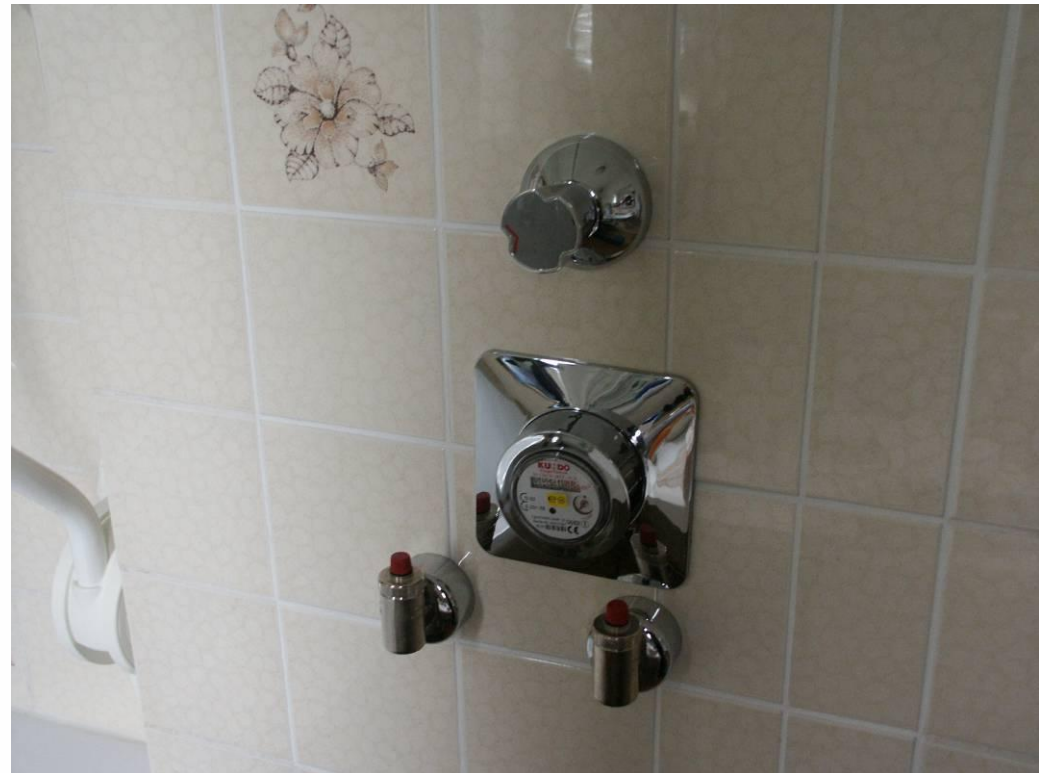
Warmwasserzähler mit Absperrventil im Badezimmer
