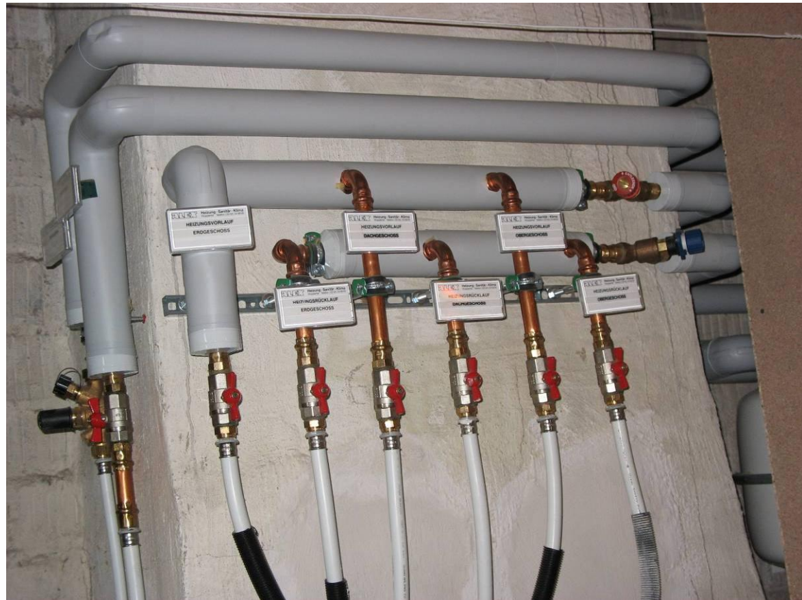
Rohrleitungen für Heizung und Warmwasser mit Absperrventilen am Kamin befestigt
