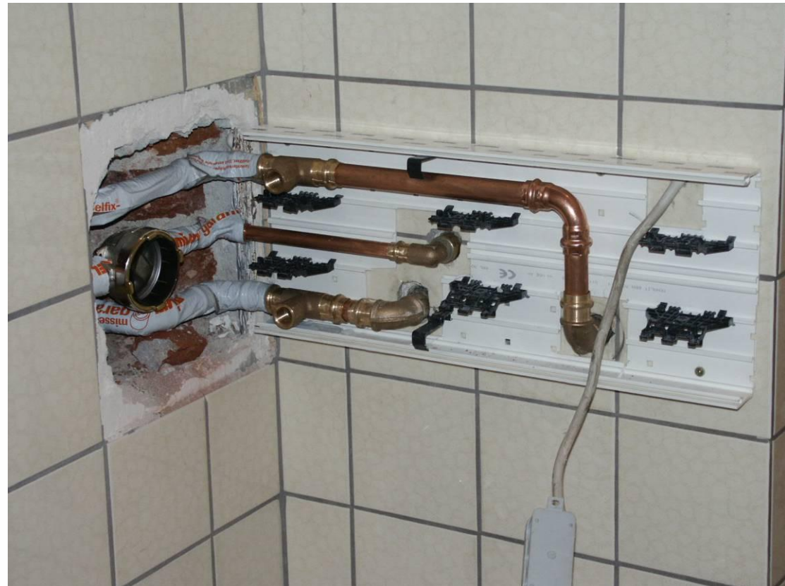
Kanalsystem im Badezimmer mit Heizungs- und Warmwasserleitungen
